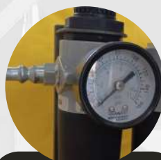
Conexão de ar comprimido.
